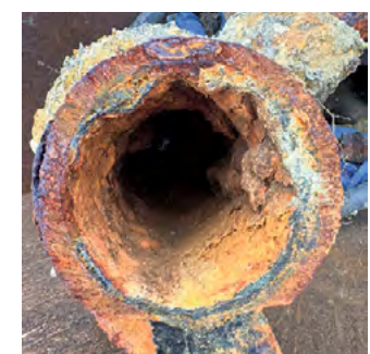
Veraltete Leitungen zwingen Verbände zu teuren Erneuerungen.
